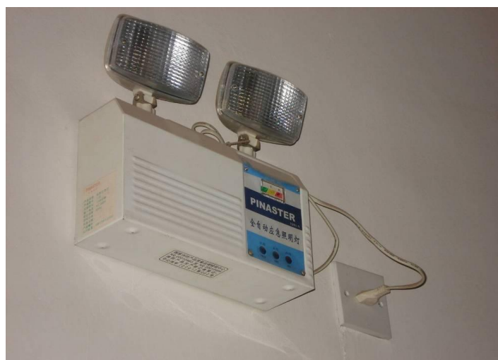
图 7-10 配电室应急照明
