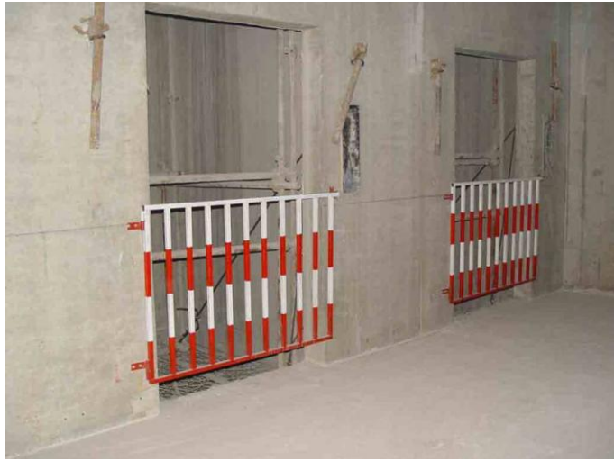
图 3-19 电梯井防护门
