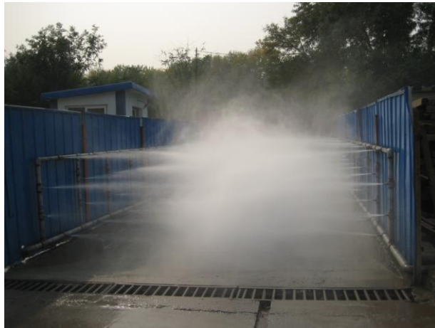
图 2-19 出入口的冲洗设施
